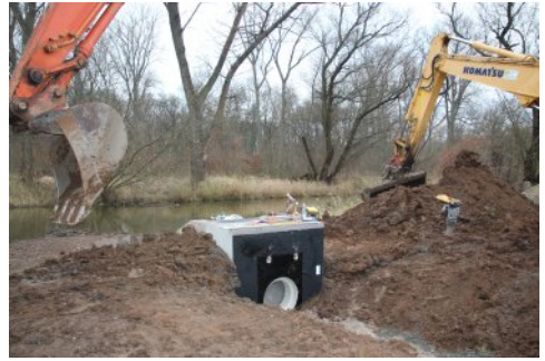
Das moderne Ersatzbauwerk wurde mit zwei Baggern im Ufer der Weißen Elster eingesetzt.
